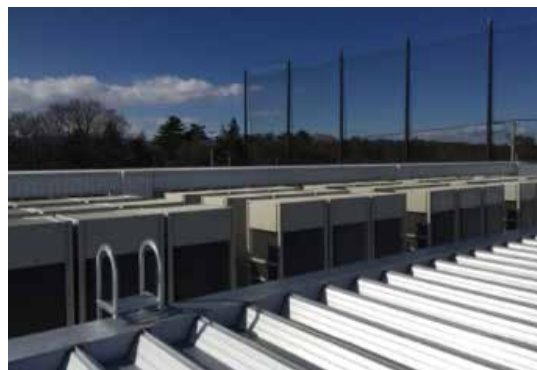
室外機設置状況
