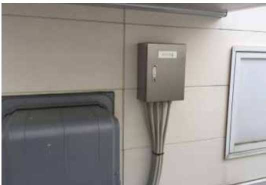
空調電力削減システム機器
